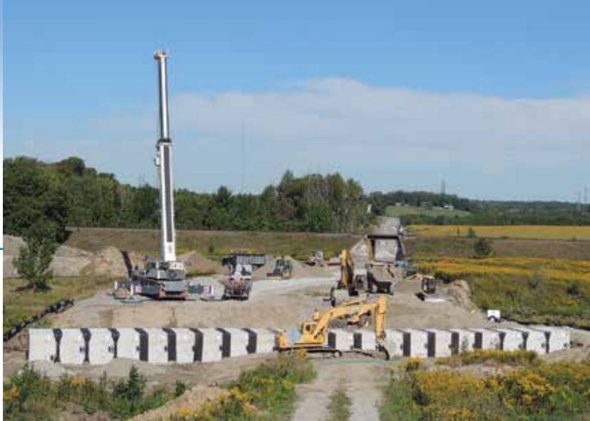
Une équipe de travailleurs installe le ponceau six sur le chemin Elliott
