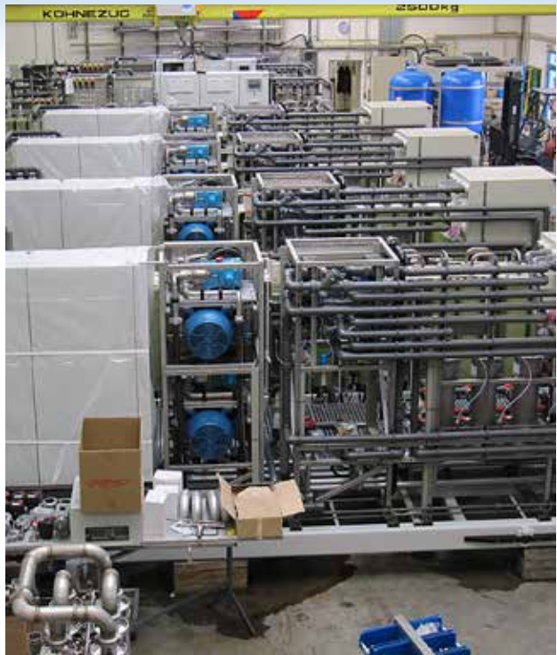
Équipement de traitement des eaux usées de ROCHEM
