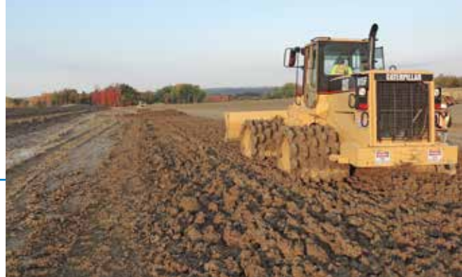
Le revêtement d'argile du monticule est en train d'être compacté par une machine connue sous le nom de « rouleau pied-de-mouton »
