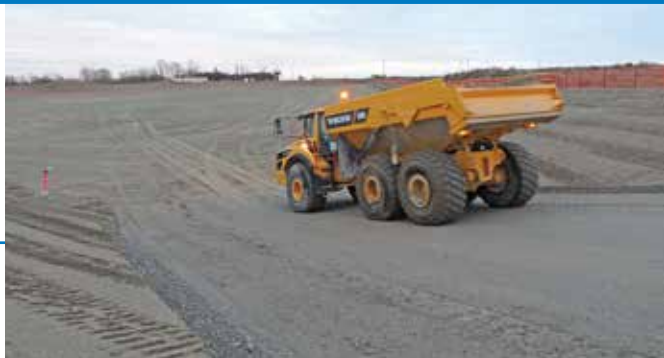
Les premiers chargements de déchets trouvés sur place sont entreposés dans l'installation de gestion à long terme des déchets
